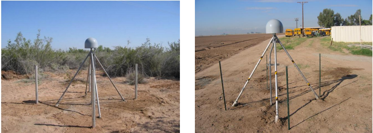
Figura 3.2: Imágenes de estaciones permanentes: P500, pertenece a CORS (Izquierda) y P496, pertenece UNAVCO (Derecha).
